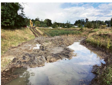
Bassin de rétention curé à moitié
